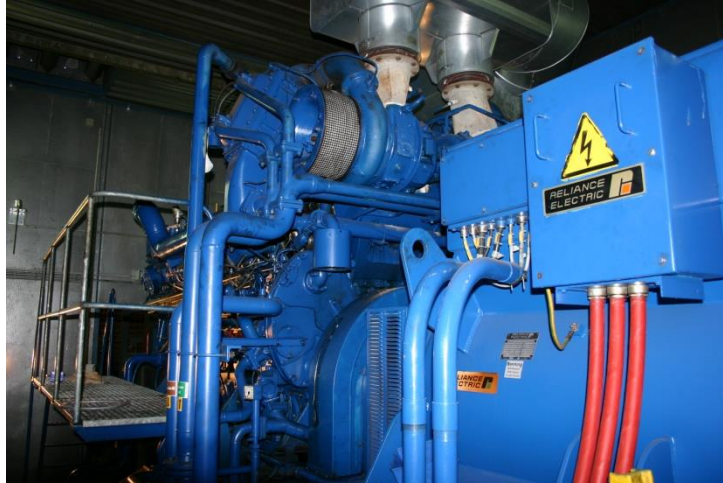
BHKW Deutz MWM
